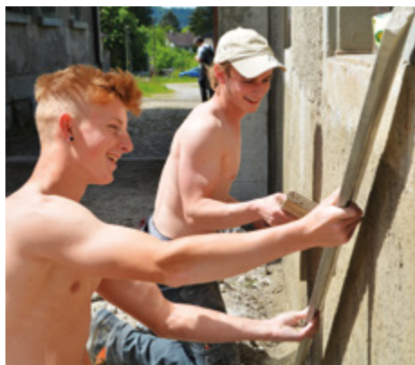
Die beiden Maurer-Lernenden Marco Germann (links) aus Winden und Lukas Rieser aus Gachnang beim Anbringen einer alten Verputztechnik.
